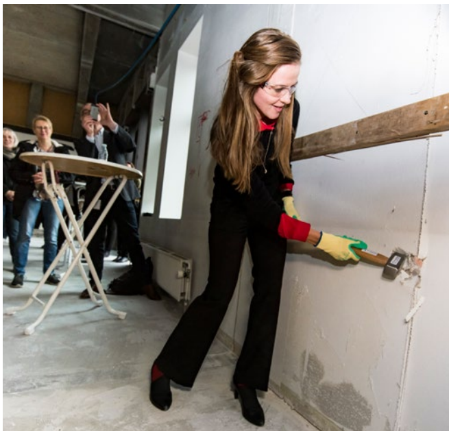
I 2018 åbner det nye gigthospital i Sønderborg. Sundhedsminister Ellen Trane Nørby besøgte byggepladsen og gav en hånd med.
